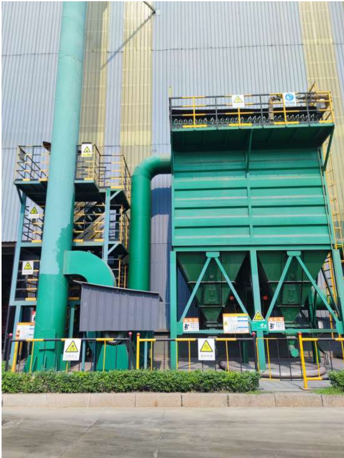
钢坯修磨废气排气筒P1-2
