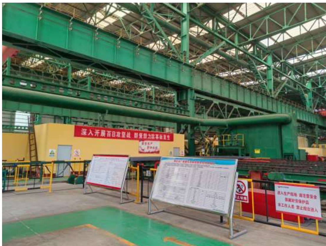
废气收集管线
